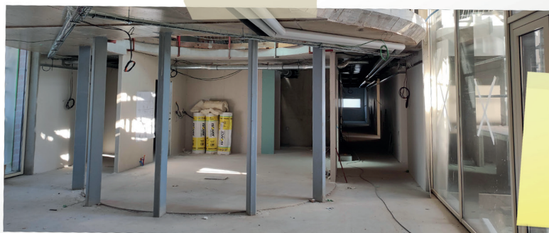
Gaines techniques eau, électricité, chauffage
